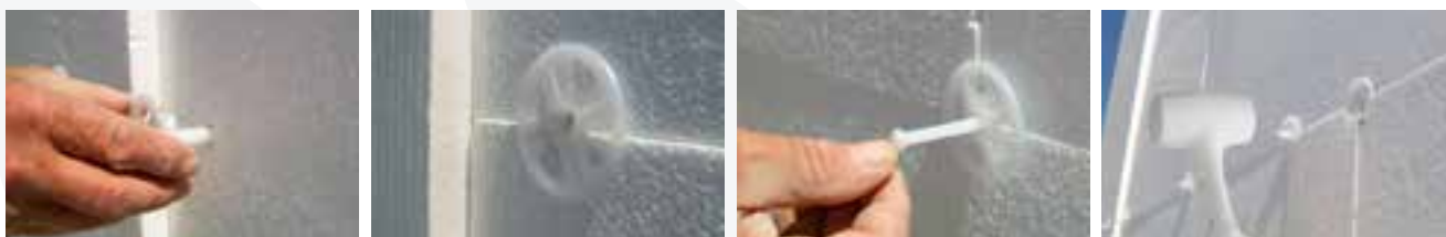
1 - Forzar el aislamiento
