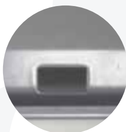
Agujeros para evacuación de agua debajo del azulejo
